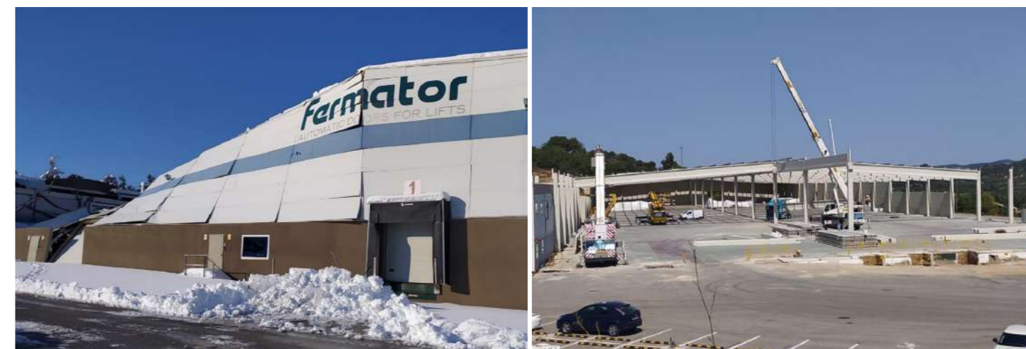
Reconstrucció de la planta a Falset després que la nevada del gener de 2021 enfonsés les instal·lacions
